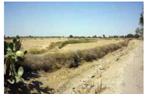
改修が必要な On Farm Canal (いずれもモロッコ)
