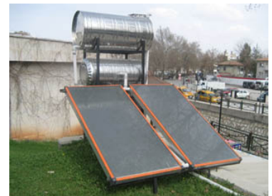
屋上の太陽熱温水器
