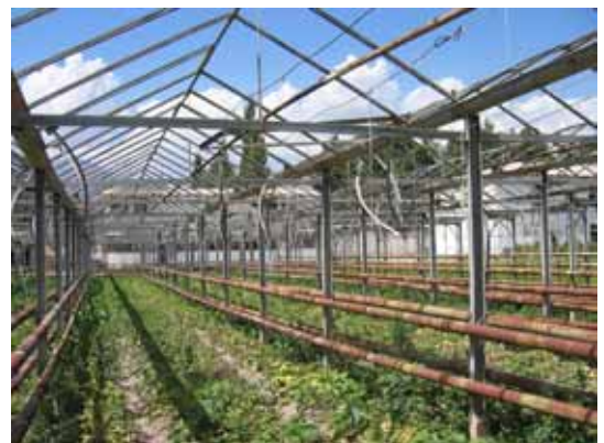
内戦で崩壊したダッチライト型温室
